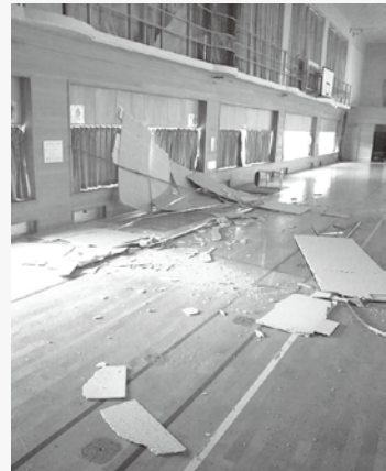
沢石中学校体育館の被害状況
